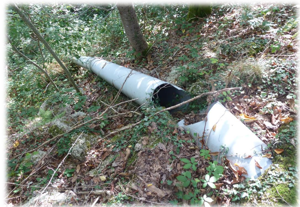
Ancienne canalisation dégradée dans l'AEI
