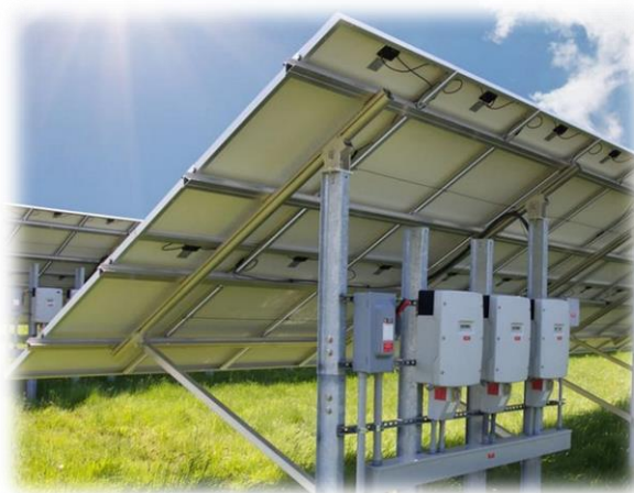
Onduleurs décentralisés sous les structures (Source : www.mon-panneau-solaire.info )
